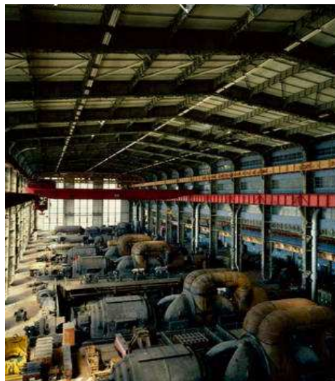
Vue de l'Intérieur de la centrale électrique de Vitry-sur-Seine
